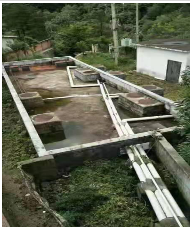
一体化污水处理设施
