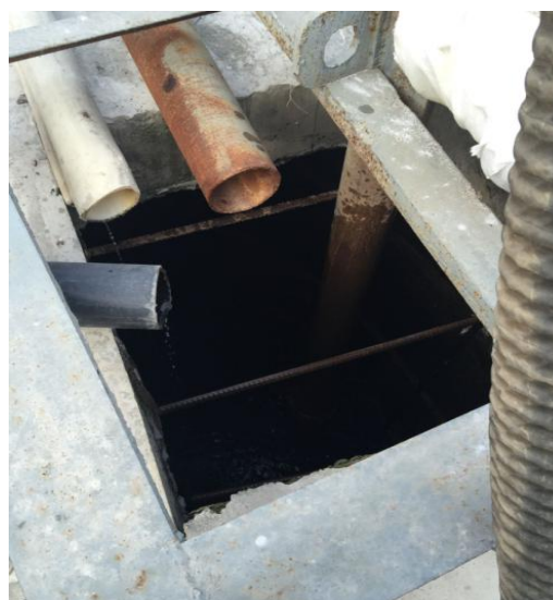
300m³ 临时事故应急池
